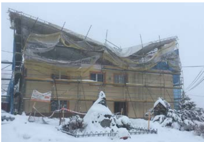
ZŠ a MŠ Trivium plus - zřícená střecha
